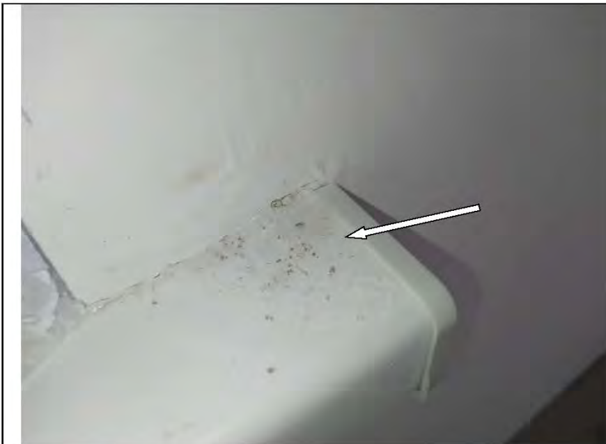
Фото №34. На лицевой поверхности подоконной доски в спальне имеются дефекты (загрязнение строительными составами).
