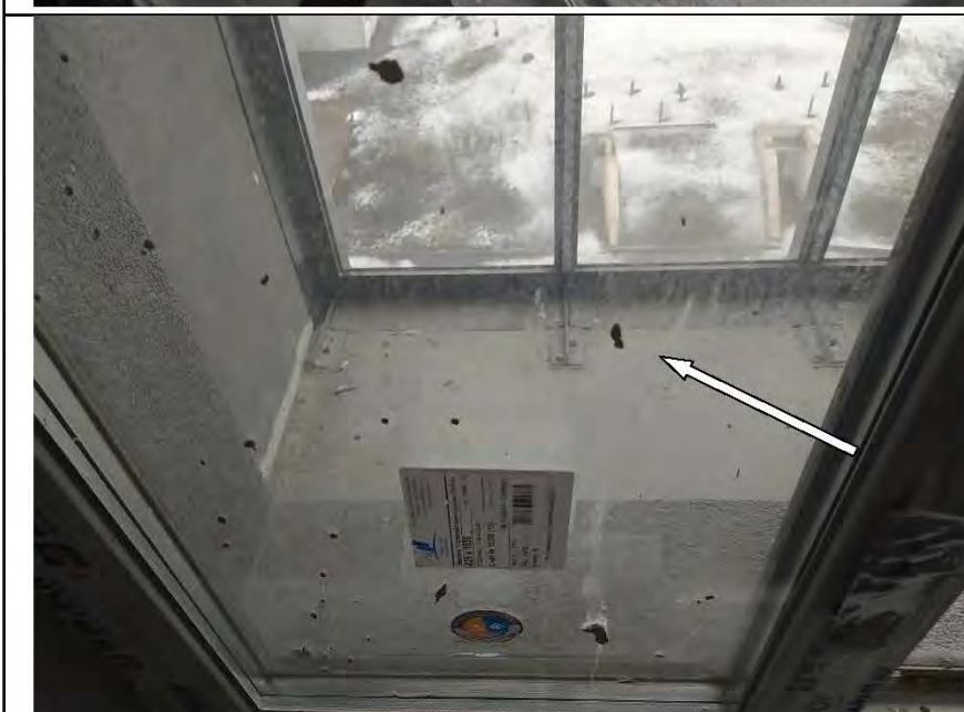
Фото №30. На стеклопакете оконного блока ПВХ в спальне имеется дефект (загрязнение строительными составами).
