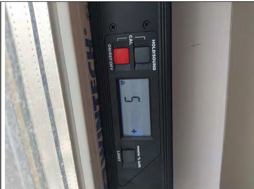
Фото №55. Отклонения оконного блока от вертикали в гостиной.
