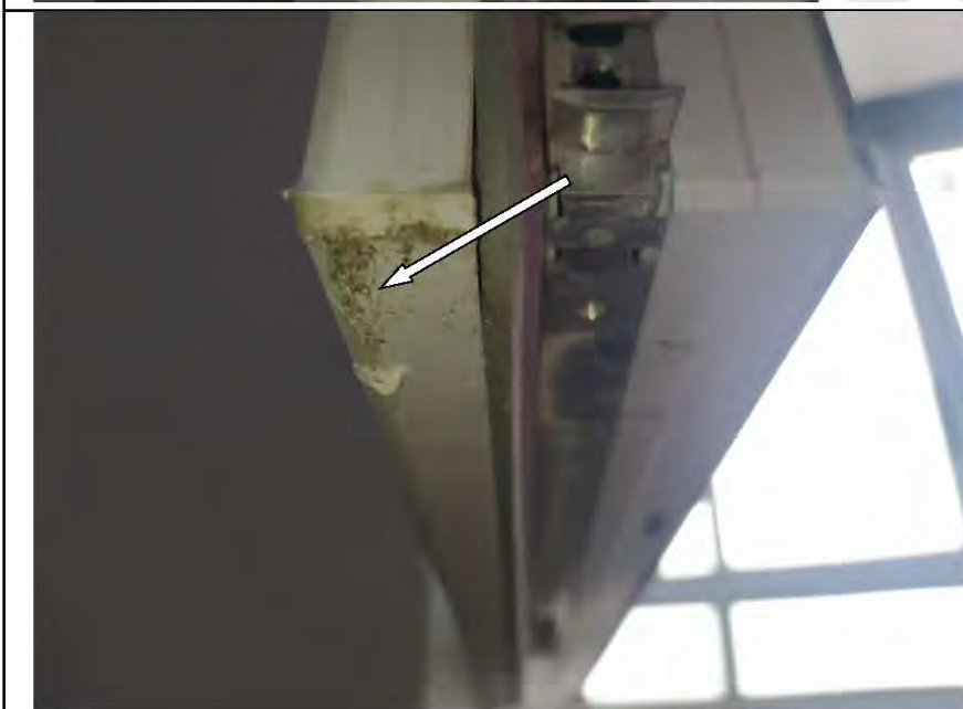
Фото №21. Профиль ПВХ оконно- дверного блока в кухне имеет дефекты (царапина).
