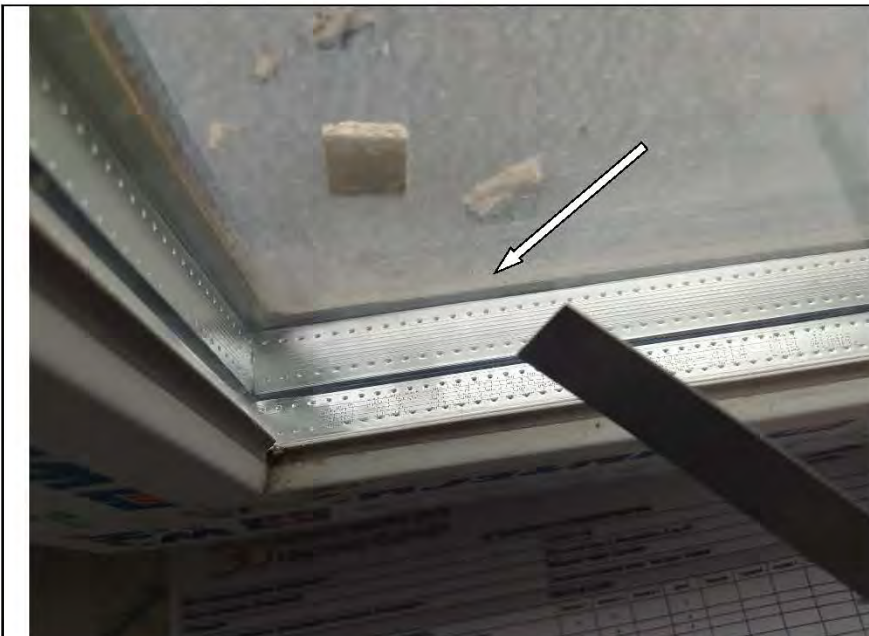
Фото №31. На стеклопакете оконного блока ПВХ в гостиной имеется дефект (окарины).
