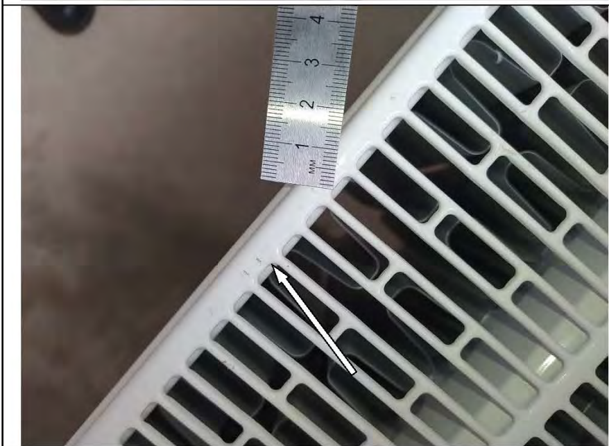
Фото №39. Отопительный прибор имеет дефект покраски защитного кожуха в спальне (сколы).
