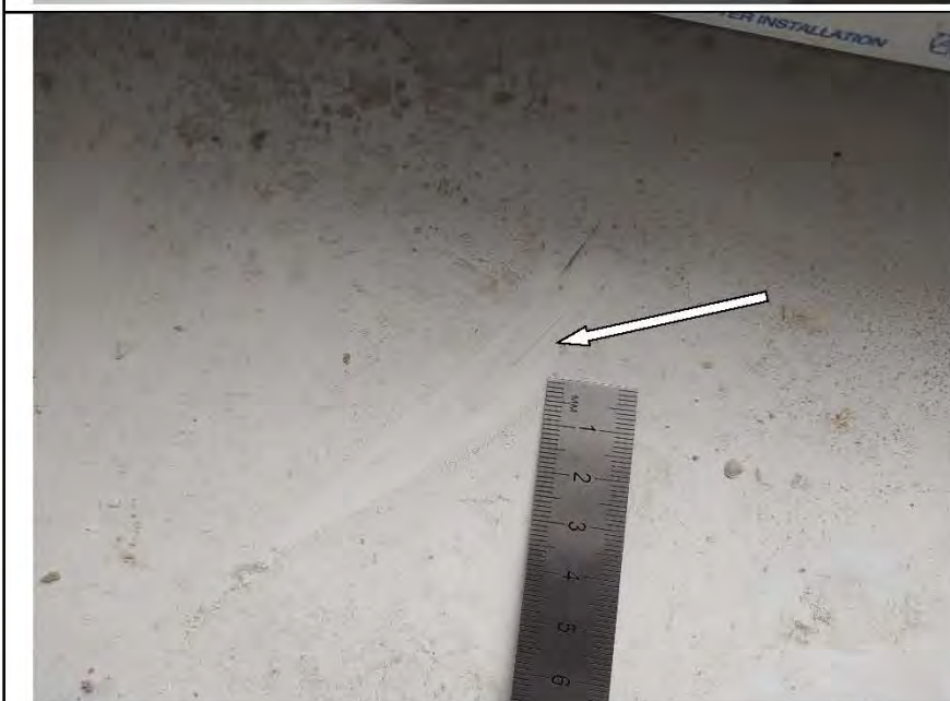
Фото №35. На лицевой поверхности подоконной доски в гостиной имеются дефекты (царапина).
