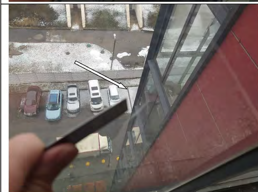
Фото №33. На стеклопакете оконного блока на лоджии имеется дефект (царапины).
