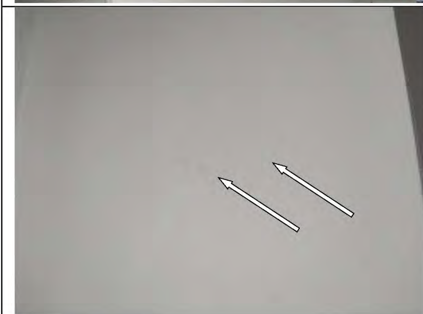
Фото №18. Шпаклеванная поверхность откосов оконного блока в спальне имеют дефекты (раковины, следы от инструментов)
