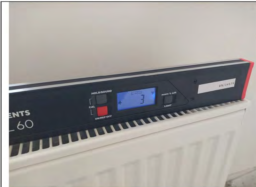
Фото №40. Отопительный прибор смонтирован неровно в гостиной.
