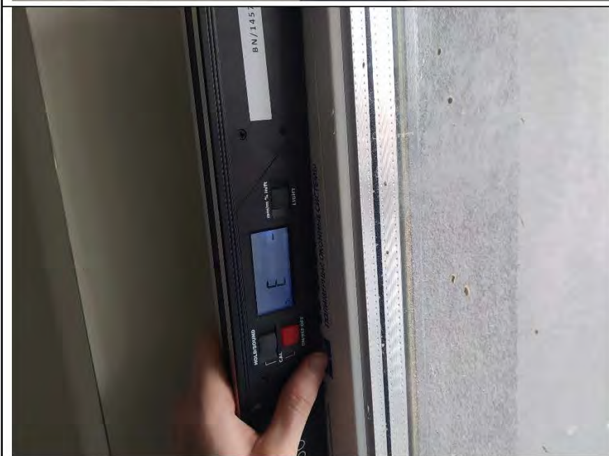
Фото №54. Отклонения оконного блока от вертикали в спальне.
