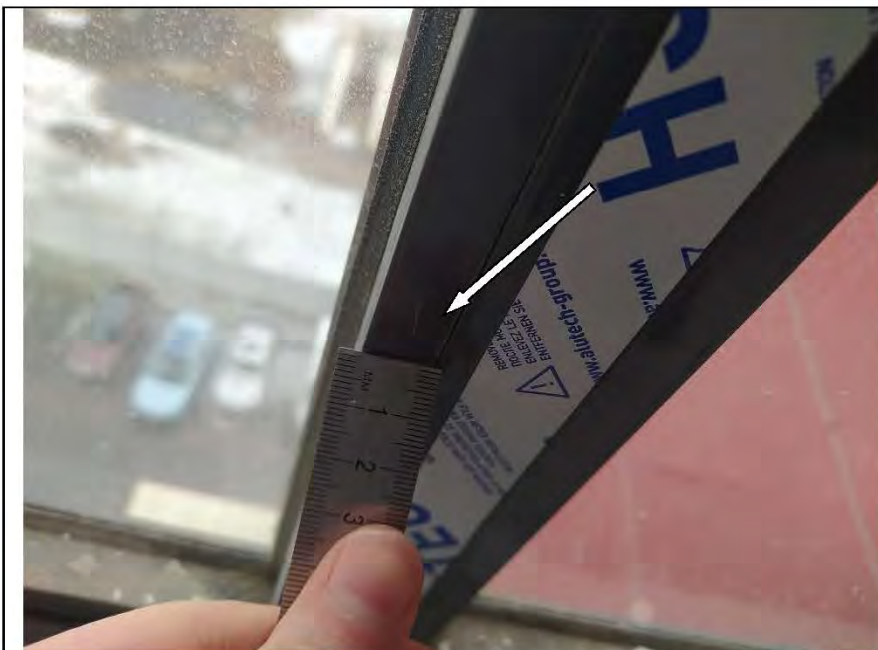
Фото №37. Дефект на металлическом профиле оконного блока на балконе (царапина).
