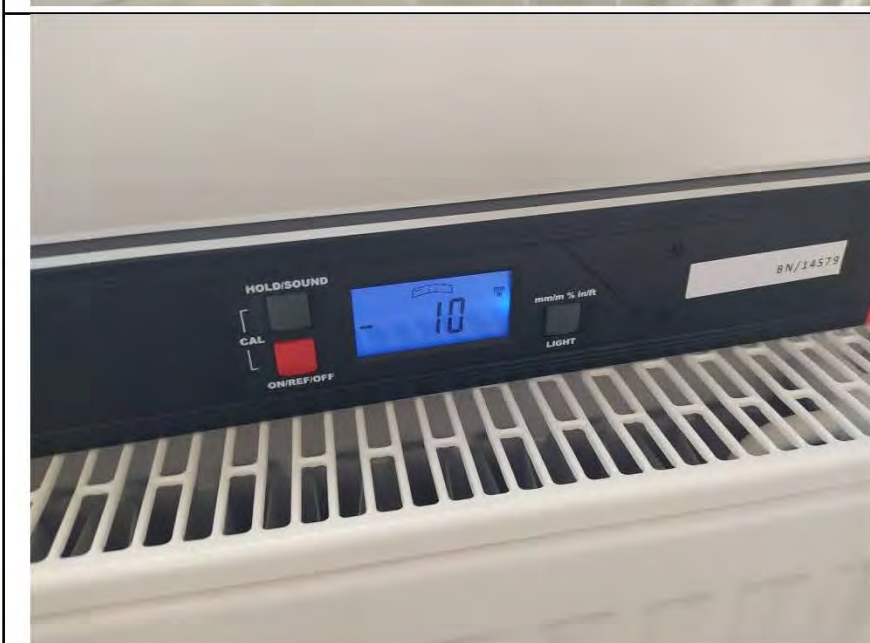
Фото №42. Отопительный прибор смонтирован неровно в спальне.
