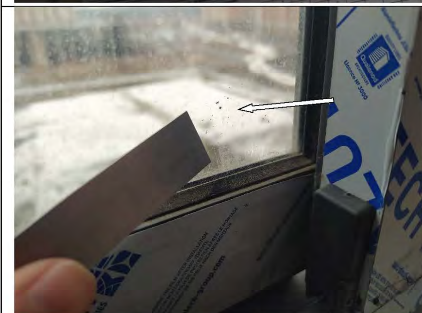
Фото №32. На стеклопакете оконного блока на лоджии имеется дефект (окарины).
