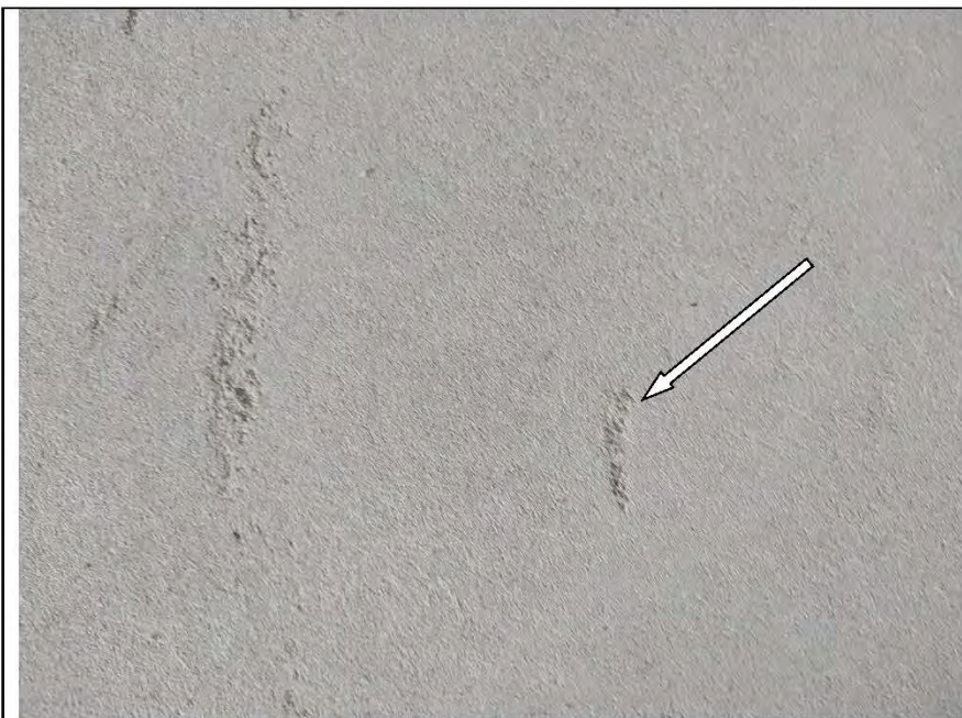
Фото №49. Готовая стяжка пола в гостиной имеет дефекты (раковины).
