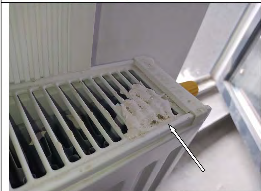
Фото №38. Отопительный прибор имеет дефект покраски защитного кожуха в кухне (загрязнение строительными составами).
