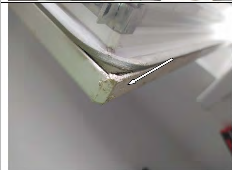
Фото №27. Профиль ПВХ оконного блока в гостиной имеет дефекты (притертость).
