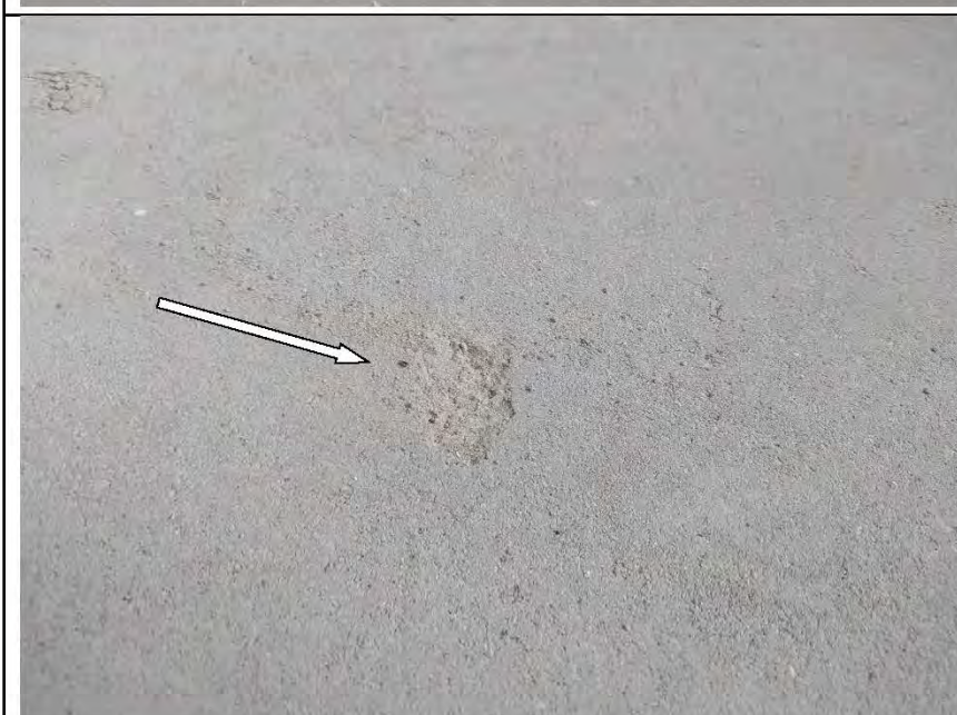
Фото №48. Готовая стяжка пола в спальне имеет дефекты (выбоины).
