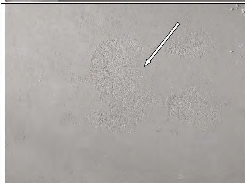
Фото №47. Готовая стяжка пола в кухне имеет дефекты (выбоины).
