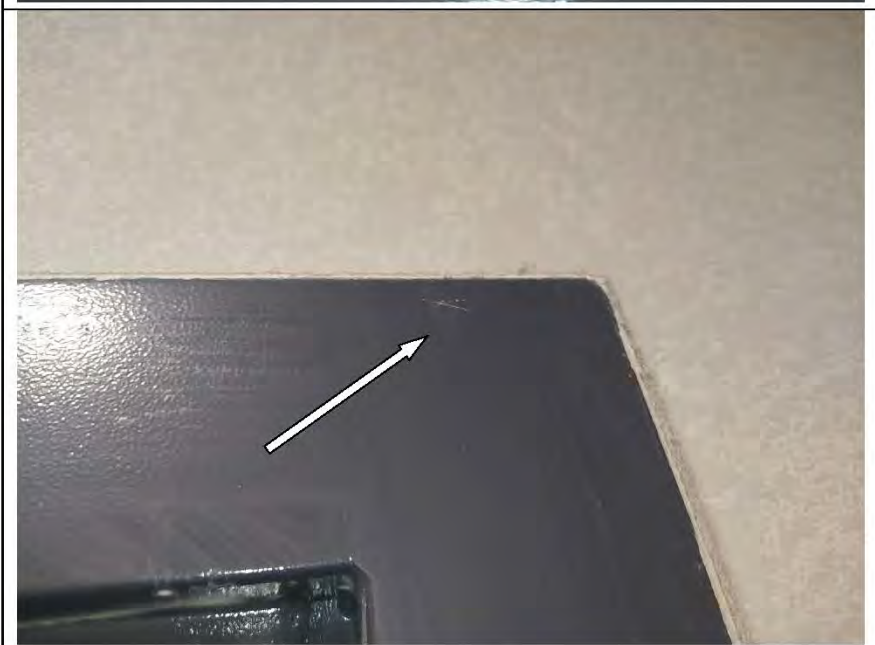
Фото №51. Коробка входной металлической двери имеет дефекты (царапина).
