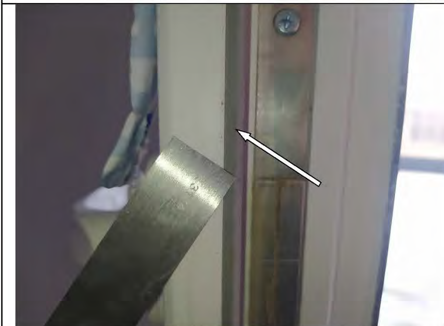
Фото №20. Профиль ПВХ оконно- дверного блока в кухне имеет дефекты (окалина).
