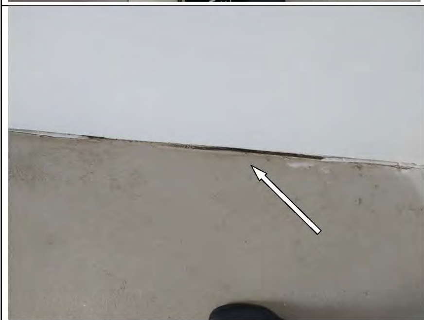
Фото №53. Изолирующие швы готовой стяжка пола в спальне выполнены с частичным отсутствием изолирующего материала
