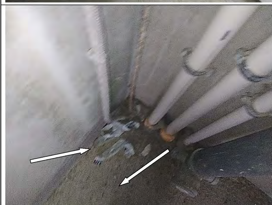
Фото №57. Отсутствует гидроизоляция в санузле. Наличие строительного мусора.
