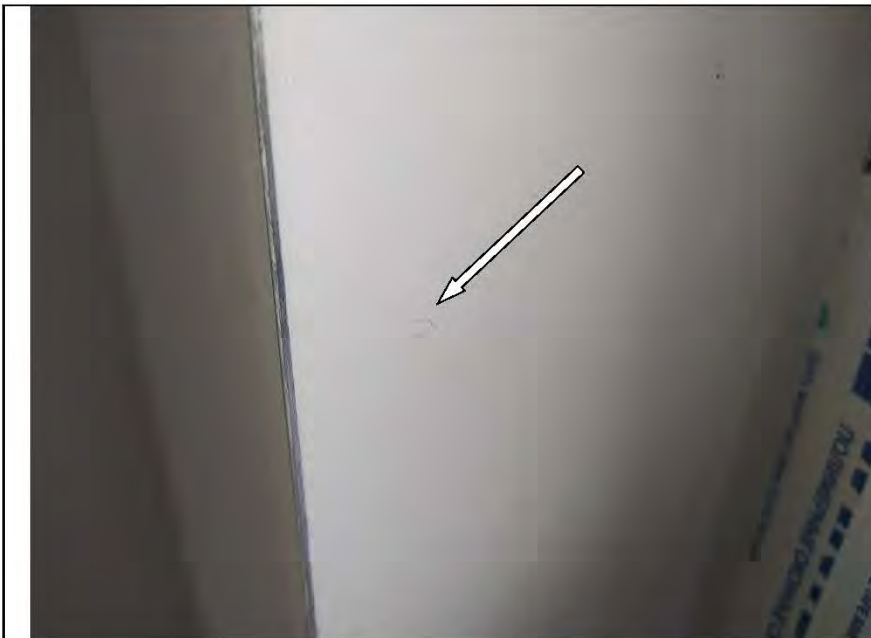
Фото №19. Шпаклеванная поверхность откосов оконного блока в гостиной имеют дефекты (раковины)
