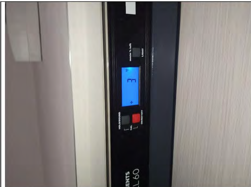
Фото №52. Отклонение полотна входного дверного блока равно 3 мм.
