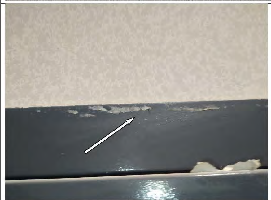
Фото №50. Коробка входной металлической двери имеет дефекты (загрязнение малярными составами).
