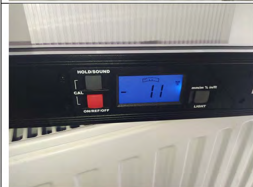
Фото №41. Отопительный прибор смонтирован неровно в кухне.
