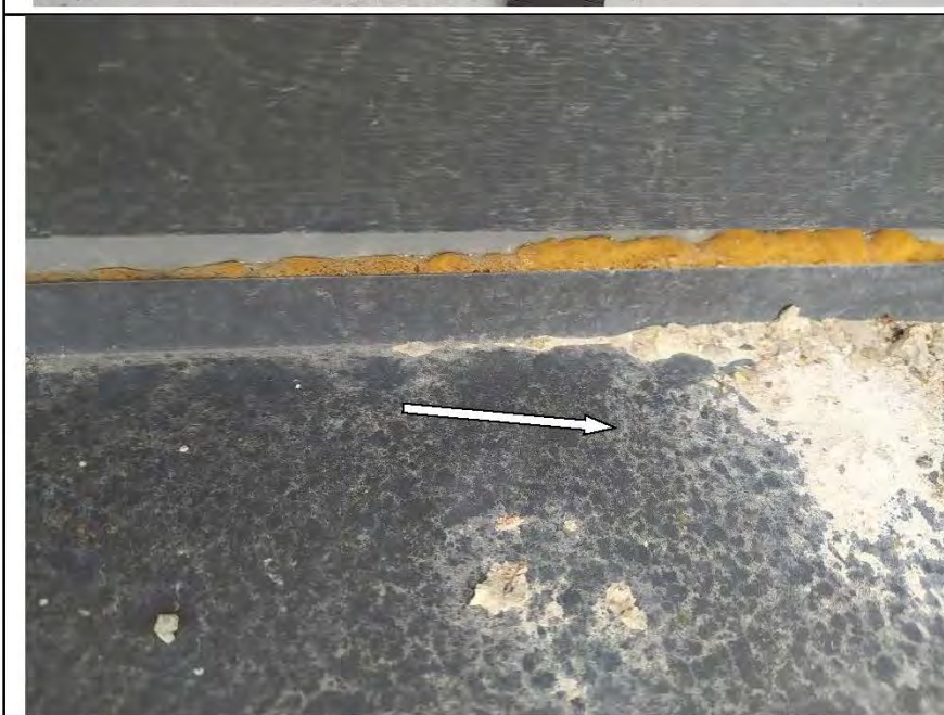
Фото №36. Металлический отлив оконного блока ПВХ в спальне имеет дефект (загрязнение строительными составами).
